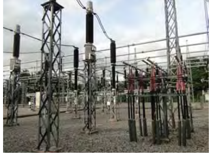
பன்னிப்பிட்டிய GSSஇல் 220 kV ஆளியாட்ச்சாலை
